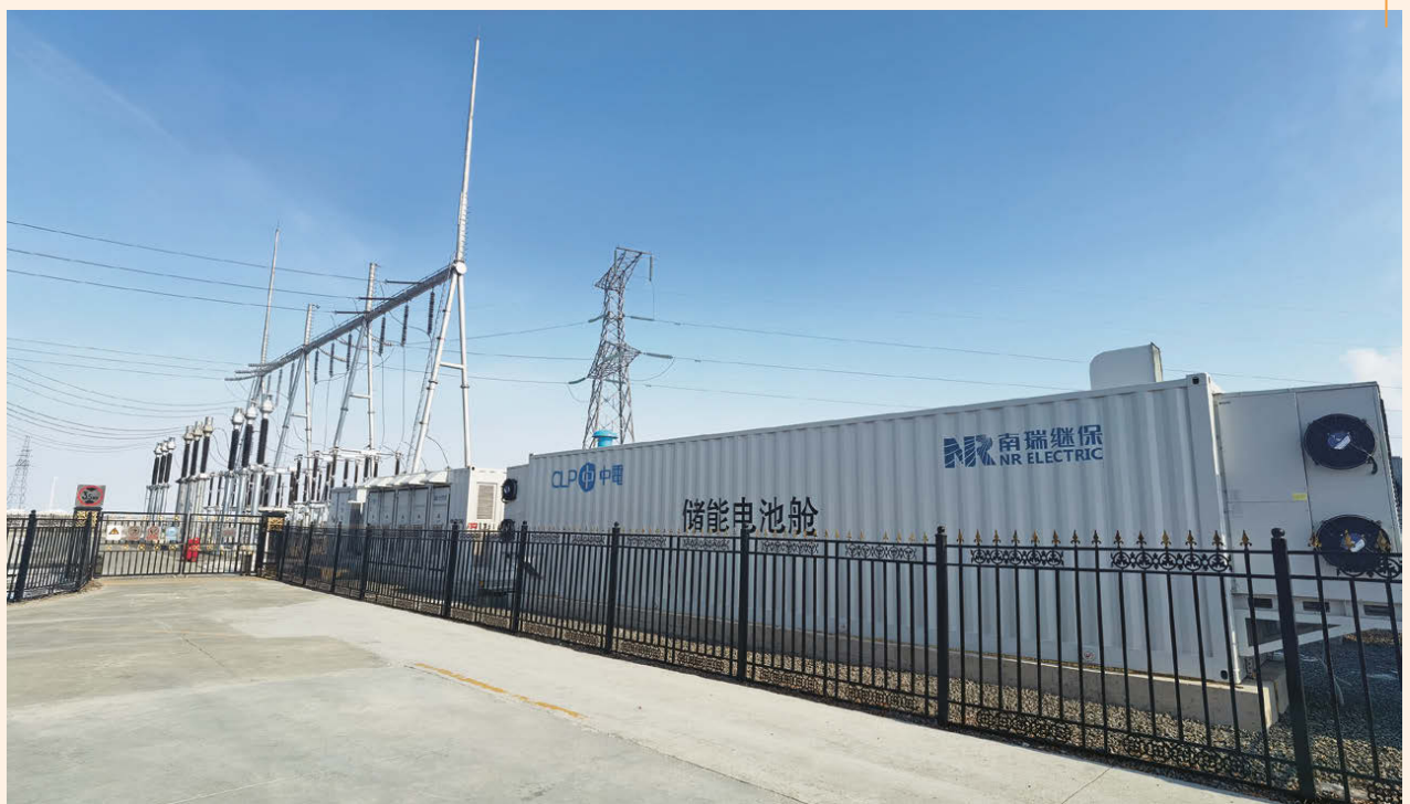
乾安三期風場是中電首個在中國內地配備電池儲能系統的項目。
