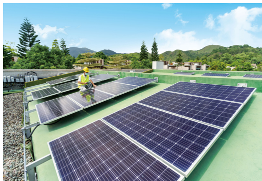
• 安裝在物業天台之太陽能光伏板
