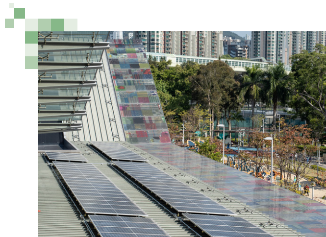
安裝於顯徑站天台的太陽能發電板
