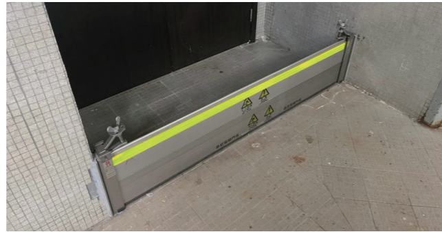
富豪機場酒店的防洪閘
