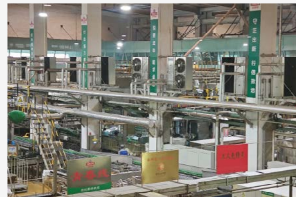
青岛啤酒二厂包装空气源热泵机组
