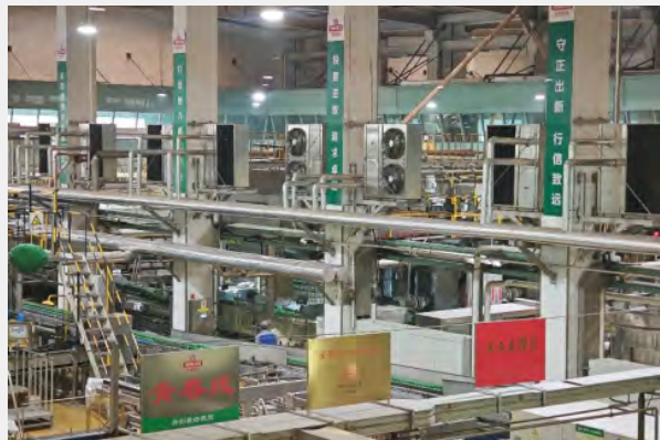
青島啤酒二廠包裝空氣源熱泵機組
