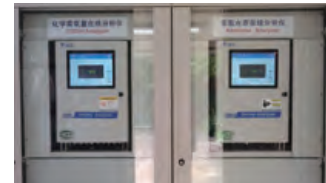
在中國上海的廢水監測裝置
