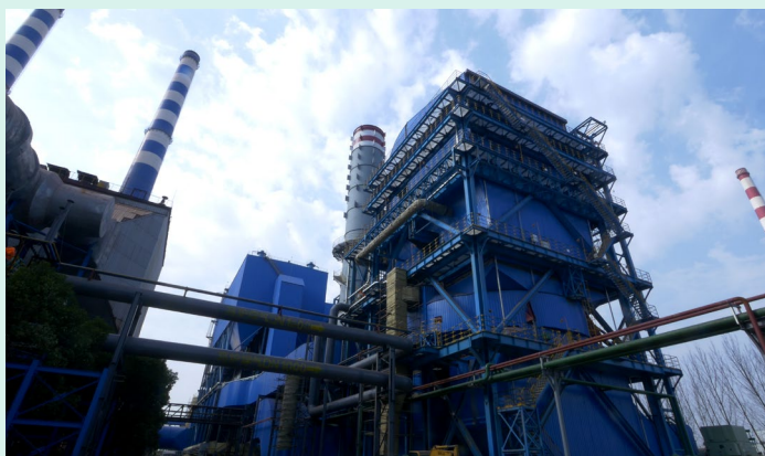
燒結機煙脫硫脫硝
