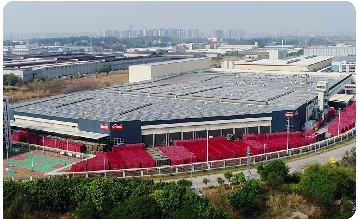
於佛山廠天台的太陽能電池板
