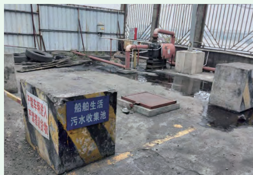
四會港－污水收集池
