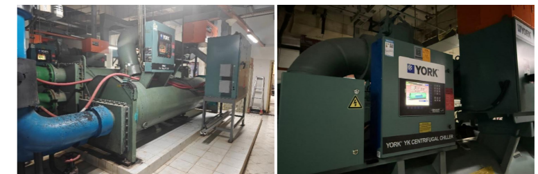
冷水机组改造前后
