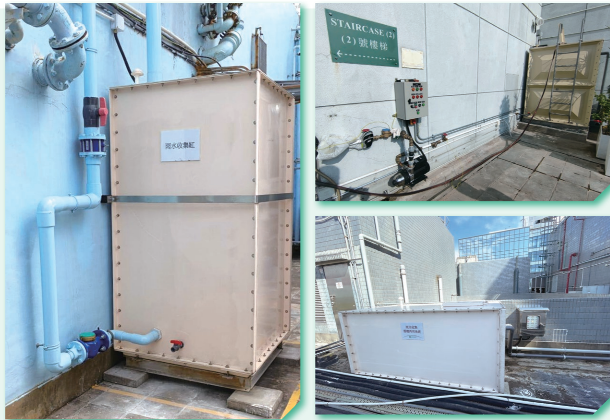
我們於都會大廈、泓富廣場及潮流工貿中心均已安裝雨水收集系統。收集的雨水用於植物灌溉，並引入沖水箱作沖廁用途。
