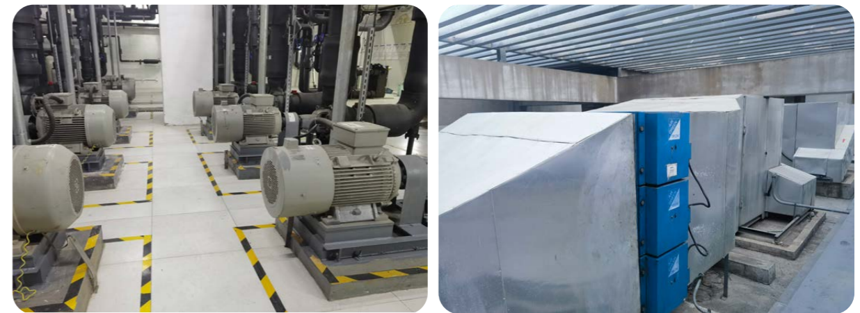
青島金茂灣購物中心空調水泵和排油煙風機變頻技術節能改造，年度節省電量約20,000千瓦時
