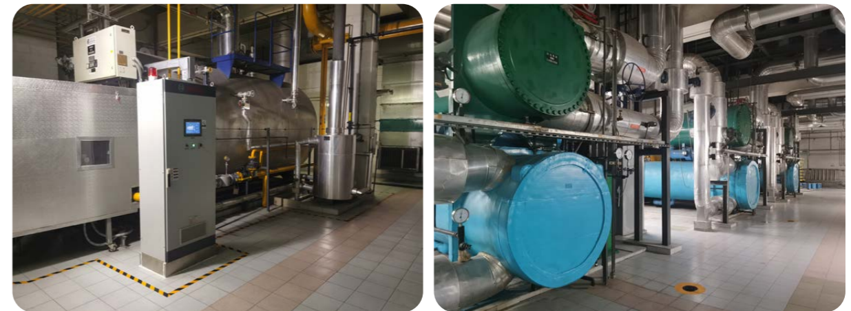
金茂大廈暖通系統設備
