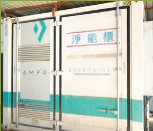
淨能櫃用於儲存多餘電力，主要為塔式起重機供電。
