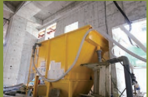
污水處理設施
