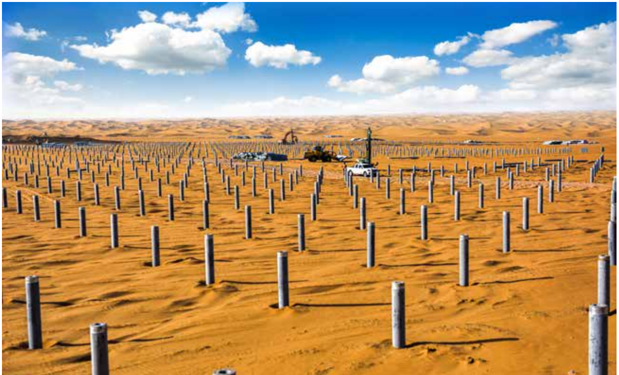
寧夏騰格裏沙戈荒新能源基地二期
