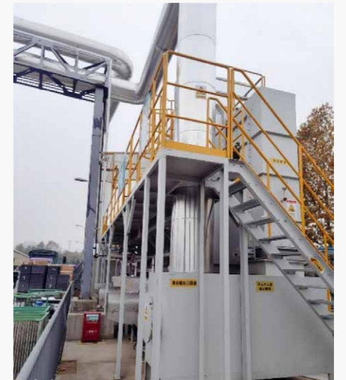
青島海信日立空調VOCs廢氣排放處理示範項目
