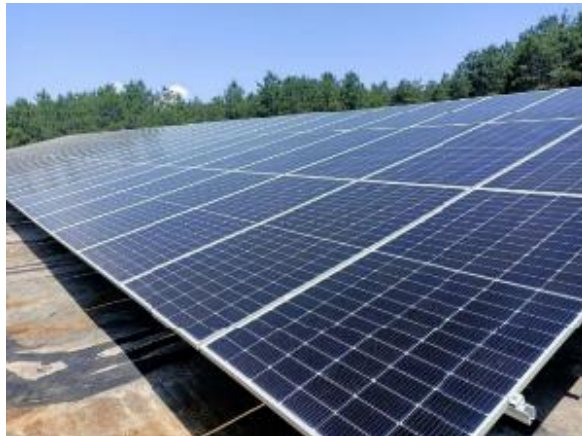
圖：臨武縣汾市鎮寺沖村綜合樓分佈式光伏發電板
