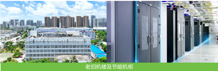
老旧机楼及节能机柜
