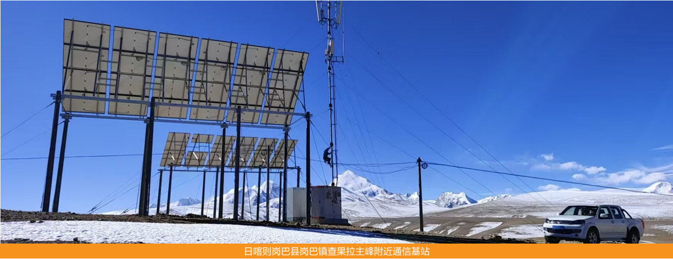
日喀则岗巴县岗巴镇查果拉主峰附近通信基站
