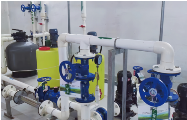
雨水收集再利用
