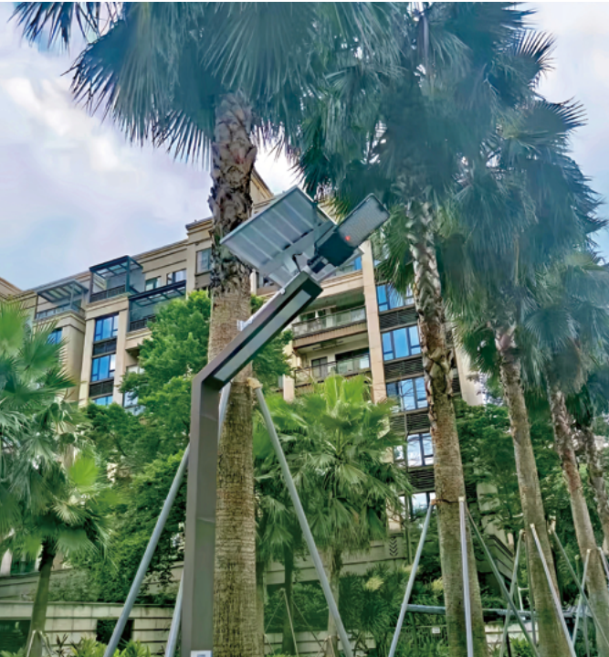
園區路燈加裝光伏
