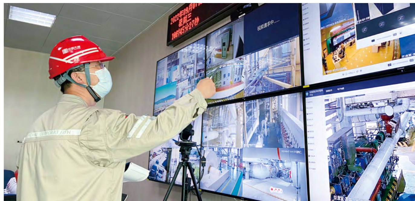
高井热电公司升级改造视频监控系统
