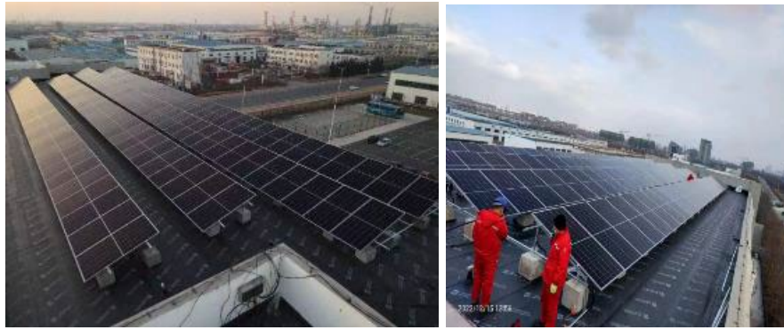
▲管具中心屋頂太陽能光伏發電
