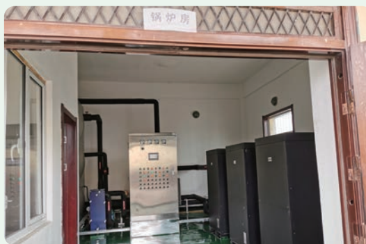
改造后的锅炉房
