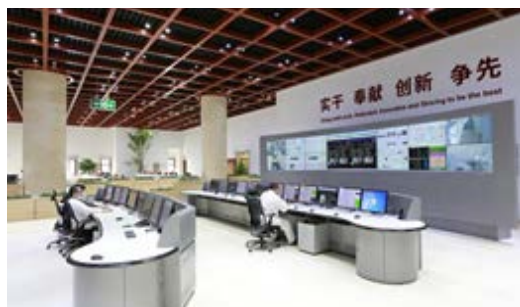
北京燃气集控中心
