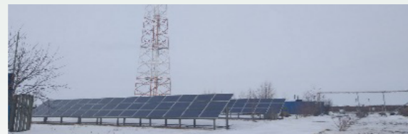
謝公司光伏電站
