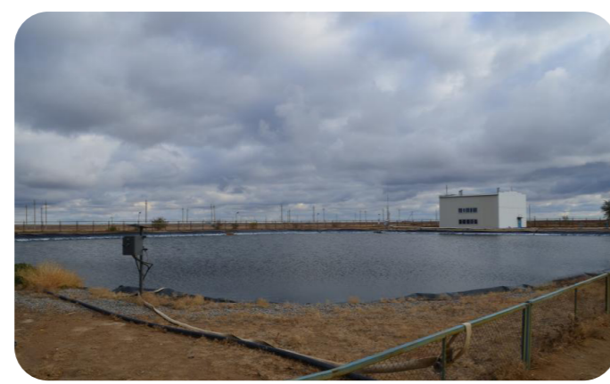
奧公司污水處理站
