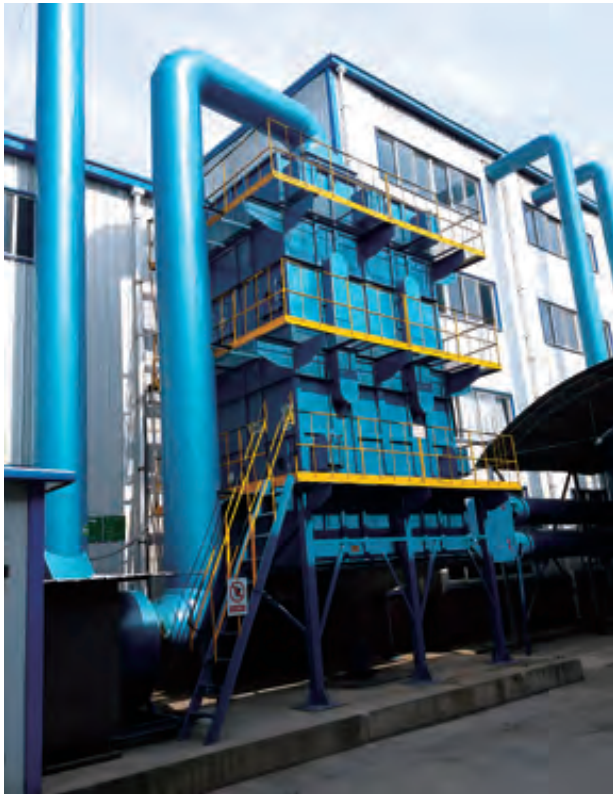
唐村公司 VOCs 治理設備
