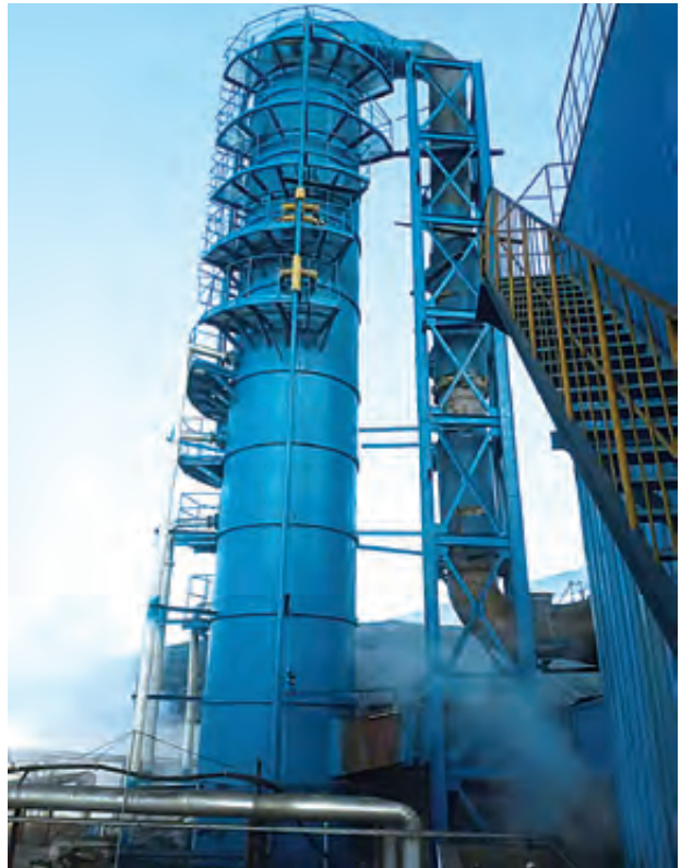
鍋爐煙氣治理改造工程脫硫塔
