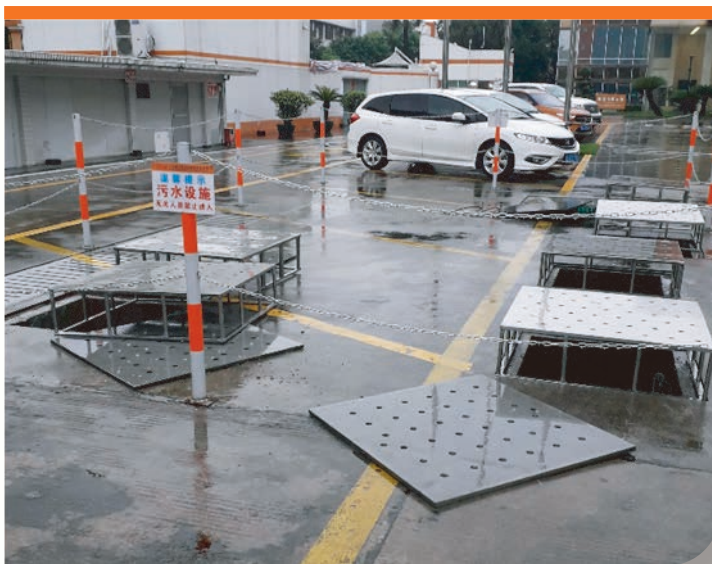
污水沉澱池(左)和污水設施(右)
