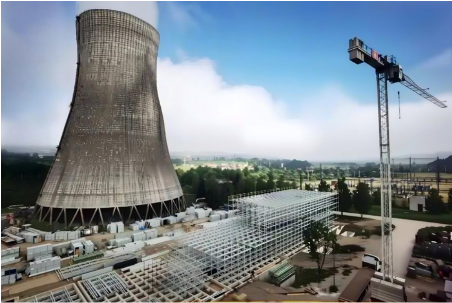
中国人保承保黑山普利电厂环保改造工程
