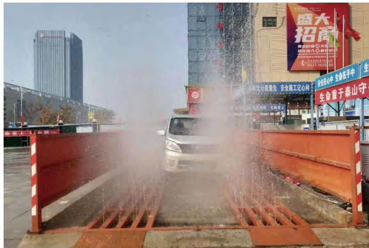
圖：污染控制措施－洗車台
