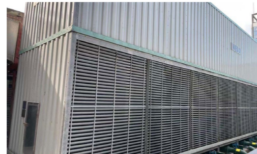
New Times Plaza Cooling Tower 新時代廣場冷卻塔
