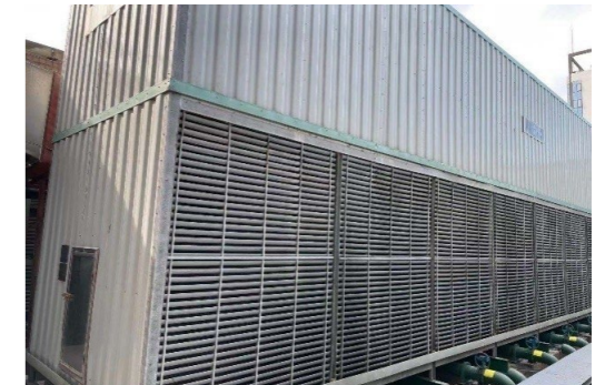
New Times Cooling Tower 新時代廣場冷卻塔
