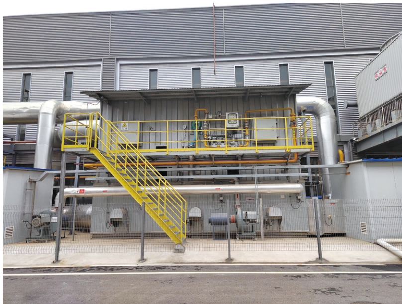
安徽生產基地RTO處理設備
