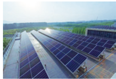
亞信科技大廈頂樓光伏設施
