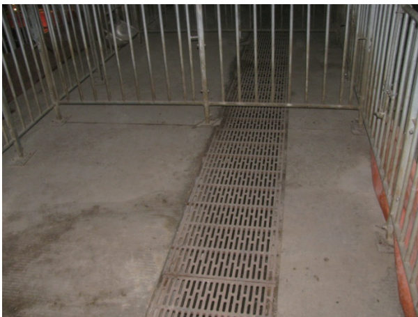
養豬欄內用於排放廢水的排水渠
