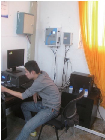
廢水處理監控系統
