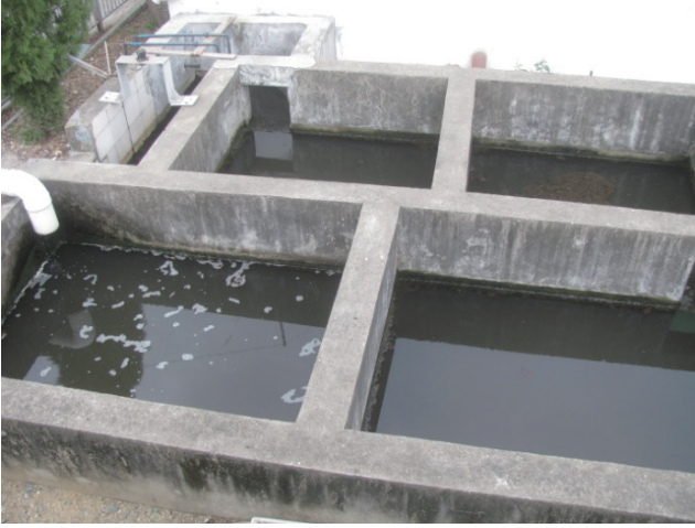
廢水過濾及處理系統
