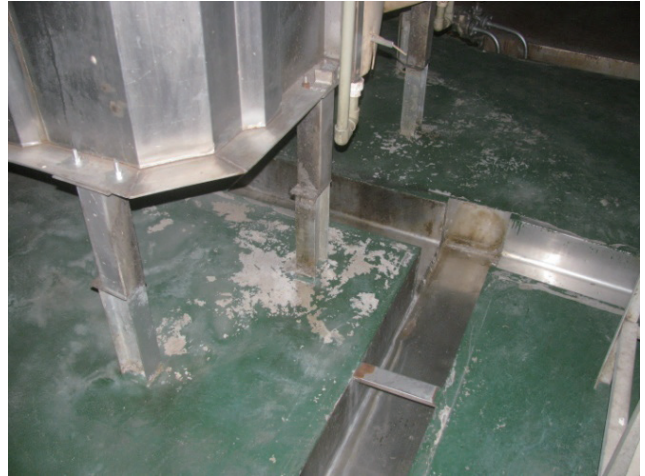
屠宰場內排放廢水的排水溝
