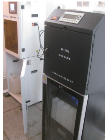
廢水處理監控系統
