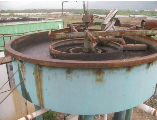
廢水過濾及處理系統
