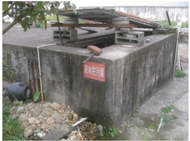
廢水過濾及處理系統
