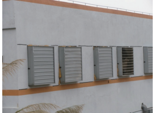
養豬欄排氣扇
