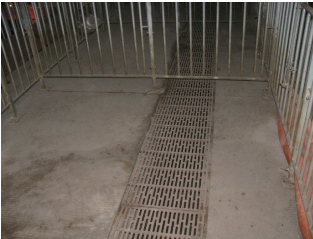
養豬欄內用於收集及排放豬糞的排水渠
