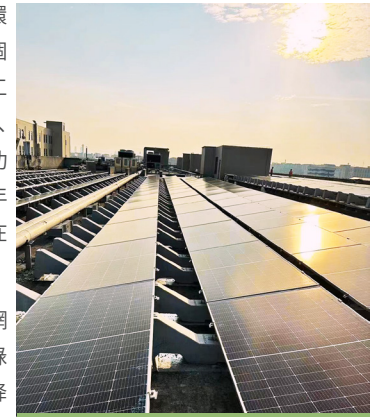
工廠屋頂分散式光伏
