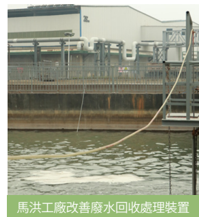
馬洪工廠改善廢水回收處理裝置
