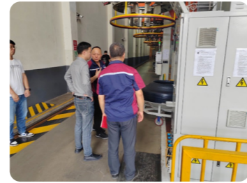
電氣安全隱患排查
