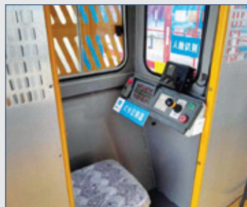
施工電梯司機人臉識別系統
