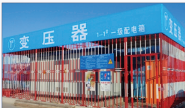
箱式變壓器防護
