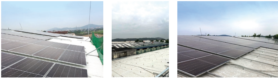
於工廠屋頂安裝的太陽能板
