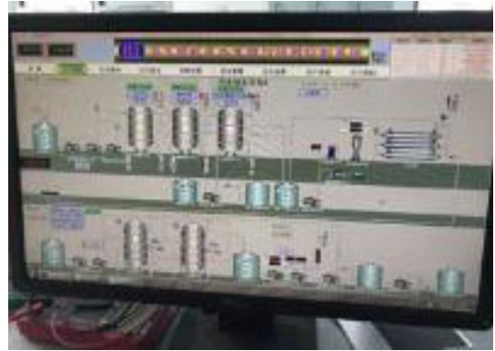
廢水處理與回用控制系統
