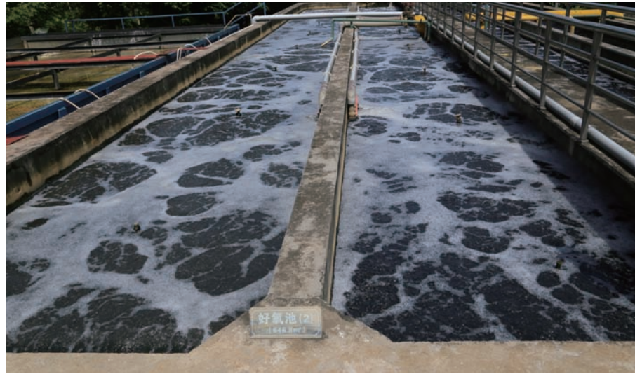
污水處理設施
