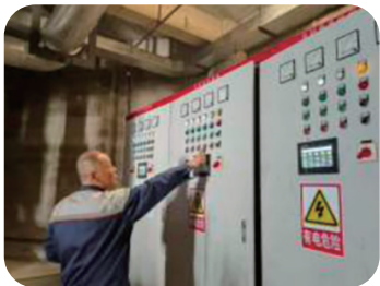
空調主機開機模式調整
