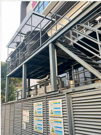
藥明巨諾蘇州生產基地廢水處理站
