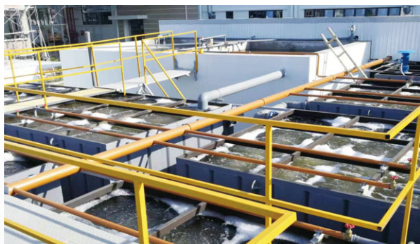
Sewage treatment at Vietnam factories 越南廠區污水處理設施
