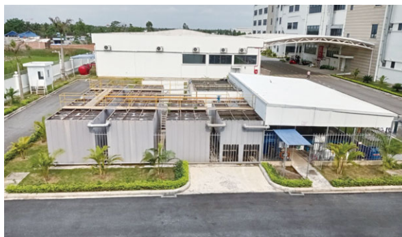
Recycling Rainwater System at Vietnam Factories 越南廠區回收再使用雨水系統
