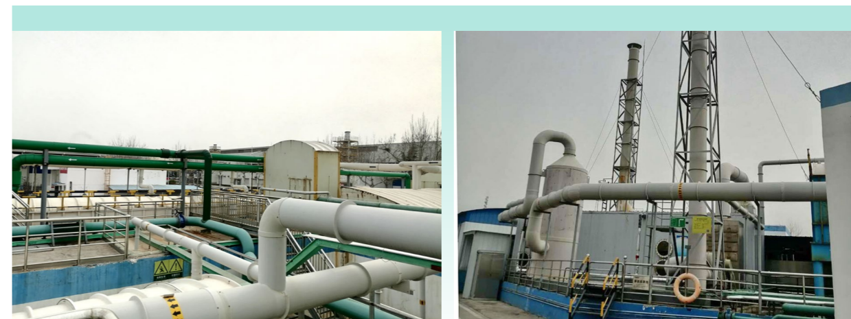
对高新区污水站恶臭气体进行收集和治理，确保污水站无恶臭气体逸散
