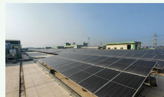
廣東安井光伏項目
