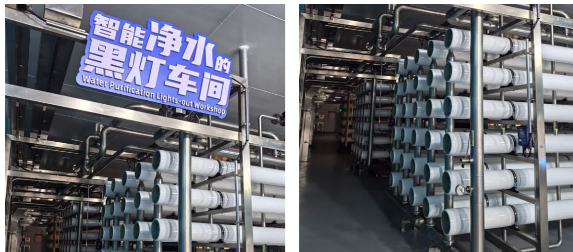
海天水處理車間
