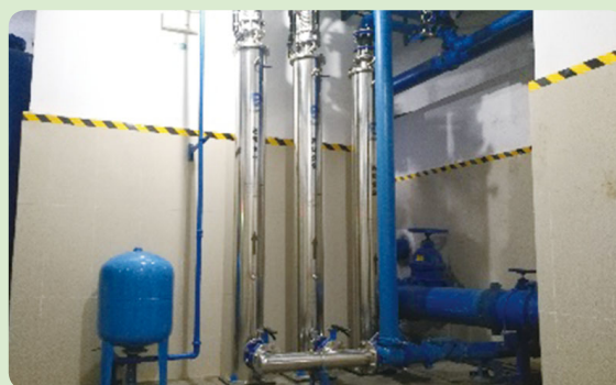
中山世紀新城水泵房設備
