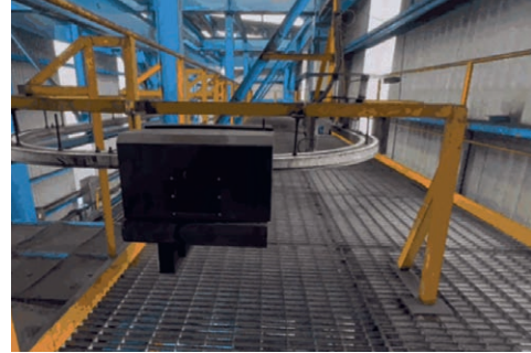
智能巡檢機器人運行中
