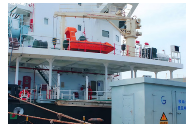
秦港股份七公司码头某轮正在进行低压岸电连接
