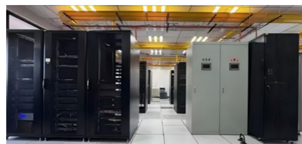
秦港股份电力公司开展800MHz数字集群系统软硬件升级
