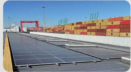
天津港歐亞國際貨櫃碼頭有限公司檢查中心屋頂光伏發電項目
