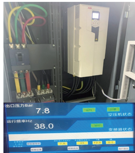
產業園公用工程工頻空壓機加裝變頻裝置， 在延長電機壽命的同時，可節約電力20%
