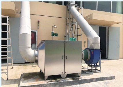
恒邦藥業危廢倉庫VOCs減排裝置
